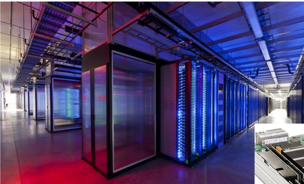
Το Datacenter της Facebook στο Prineville: 500 Racks
